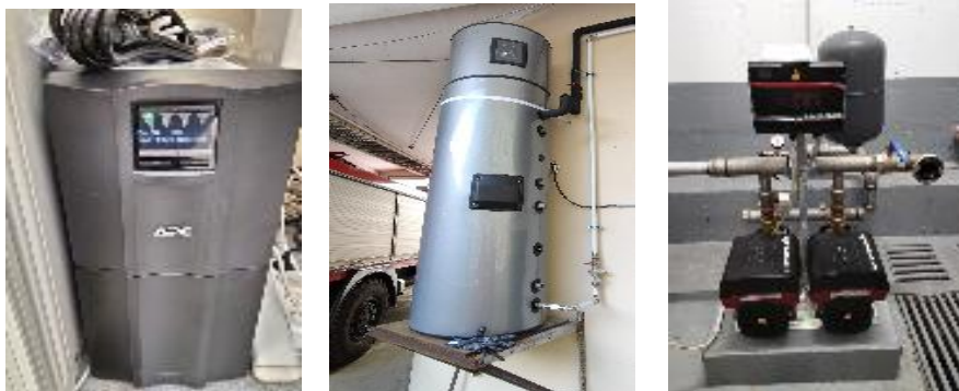
Figura 14 Grupo de bombagem de abastecimento as viaturas; Bomba de calor para produção de água quente sanitária; UPS's de apoio à central de telecomunicações e á área administrativa; Grupo de bombagem de abastecimento as viaturas
